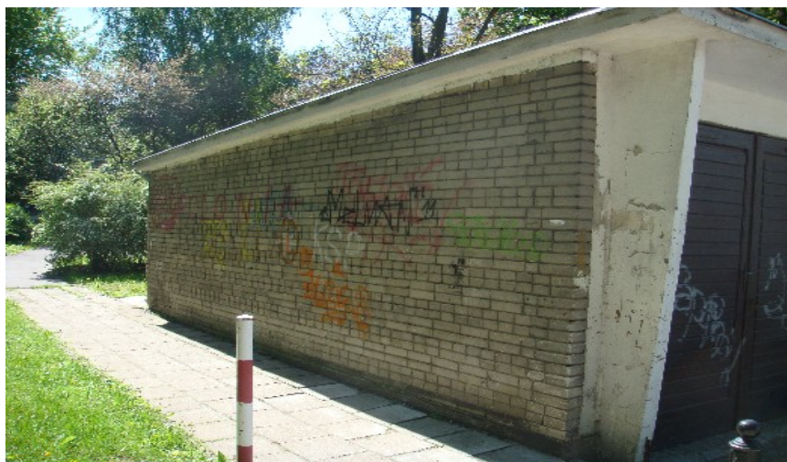
Widok ścian pawilonu z niewielkimi uszkodzeniami tynku i napisami „graffiti”:
